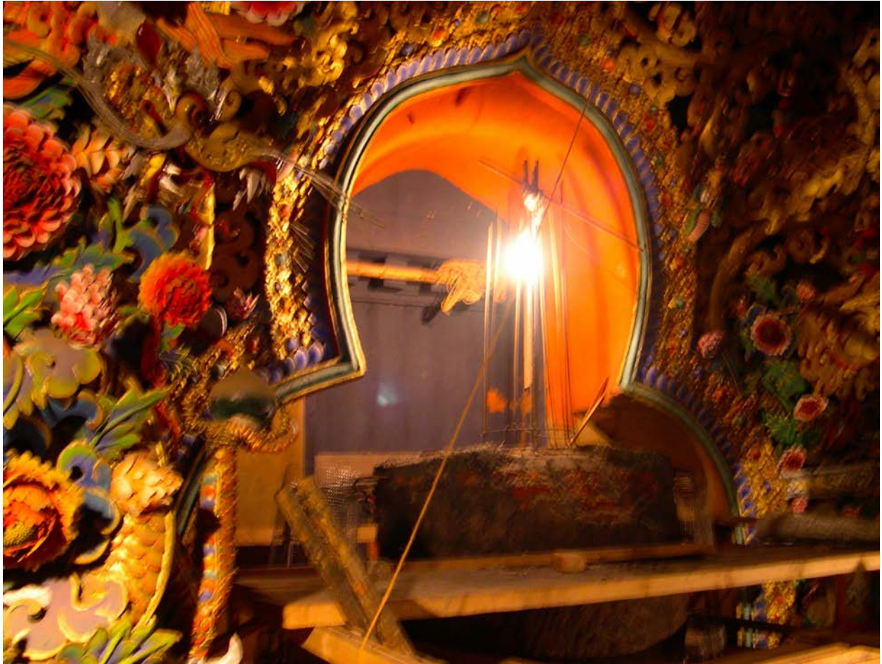
歷史悠久的寺院裡，工匠在重塑一尊傳統木制大佛像時，為了照明而錯誤使用電線。
